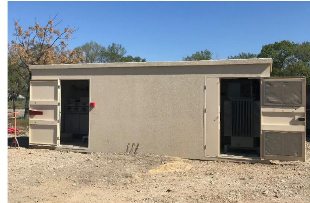
Figure 5 : Photographie d'un poste de livraison/transformation
